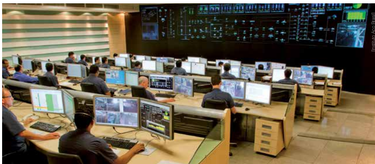
Usina de Ipatinga/MG - Centro de Controle Integrado.
